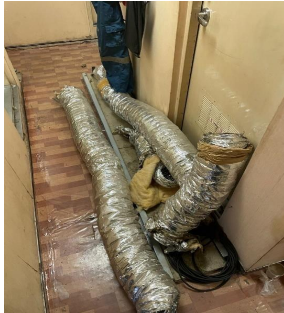
Gambar 4. Contoh Flexible Ducting Lama Hasil Pembongkaran di Ruang Akomodasi.
